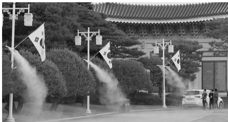
청와대 춘추관 일원에 설치된 쿨링포그
