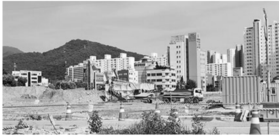
9일 17명의 사상자를 낸 광주 동구 학동4구역 붕괴 현장에서 '학동참사 2주기 추모제'가 열리는 가운데, 학동4구역 내 철거가 진행되고 있다.
