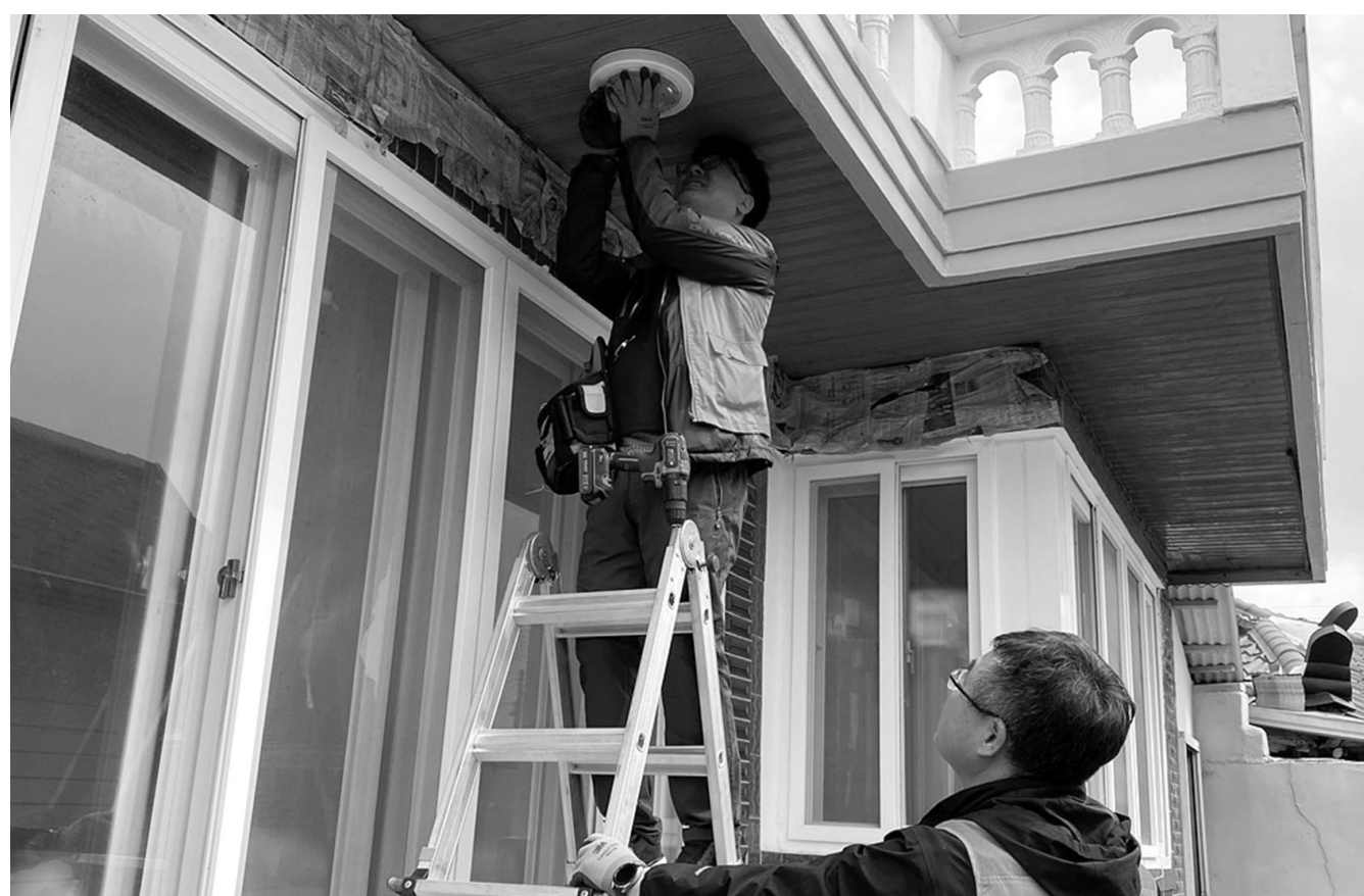
한화솔루션 행복나눔가전서비스 봉사단과 쌍봉종합사회복지관이 지난 25일 여수시 화정면 여자도를 찾아 전기수리 봉사활동을 펼쳤다.
