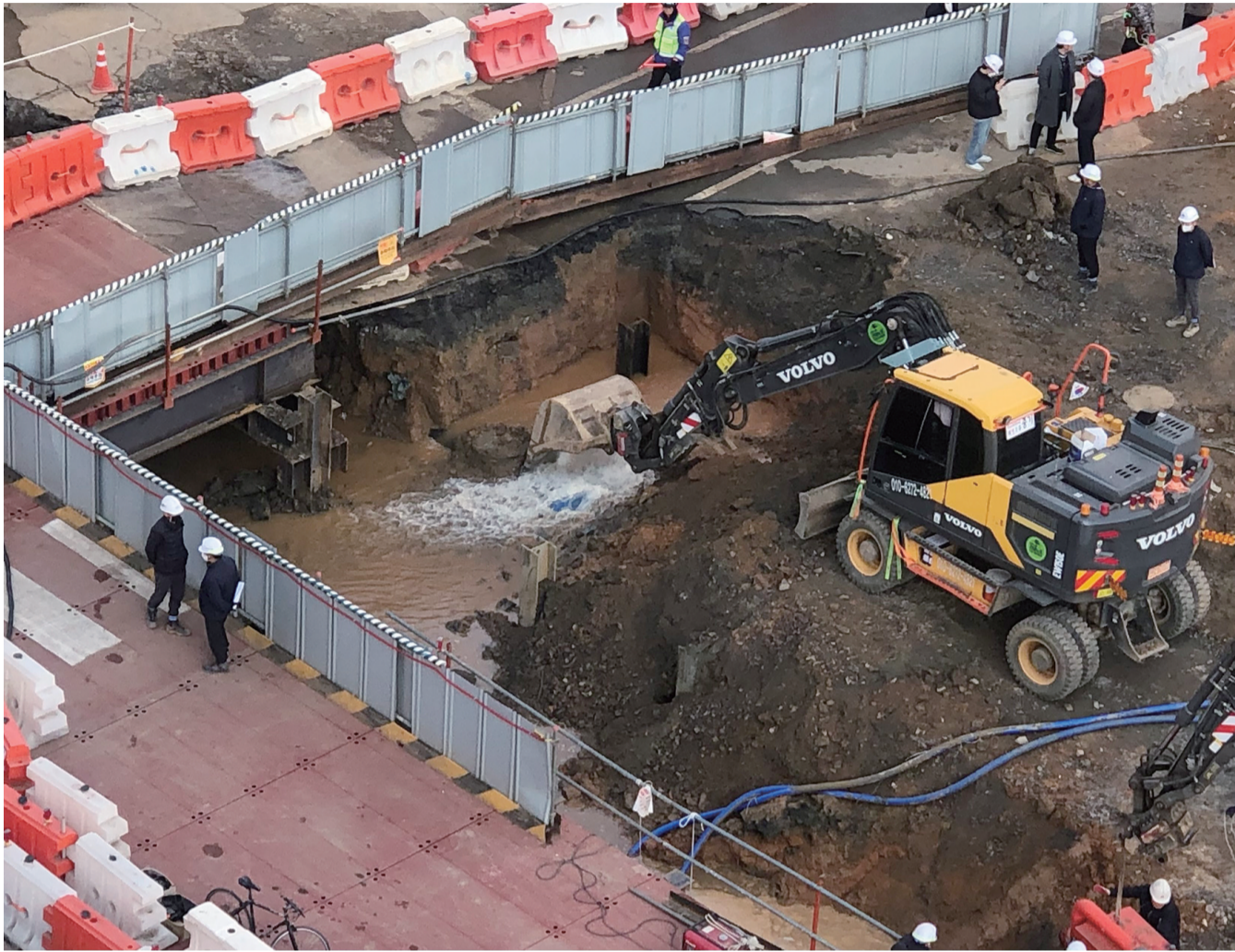
14일 오전 8시45분께 광주 남구 백운광장 인근 지하철 2호선 공사(1단계 4공구) 현장에서 50mm 상수도관이 파손됐다. 복구 작업은 6시간 만인 오후 3시께 완료됐으며, 이 사고로 인해 180톤에 달하는 물이 누수됐다.
