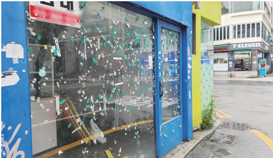
12일 찾은 광주 동구 충장로의 한 빈 상가, 불법 전단지를 붙였다 떼 자국들로 건물 외벽이 더럽혀진 모습이다.
