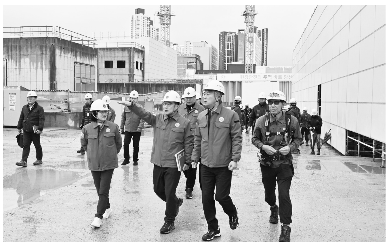
광주 서구는 오는 6일까지 동절기 안전사고 예방을 위한 관내 건설공사장 안전점검을 실시한다.
