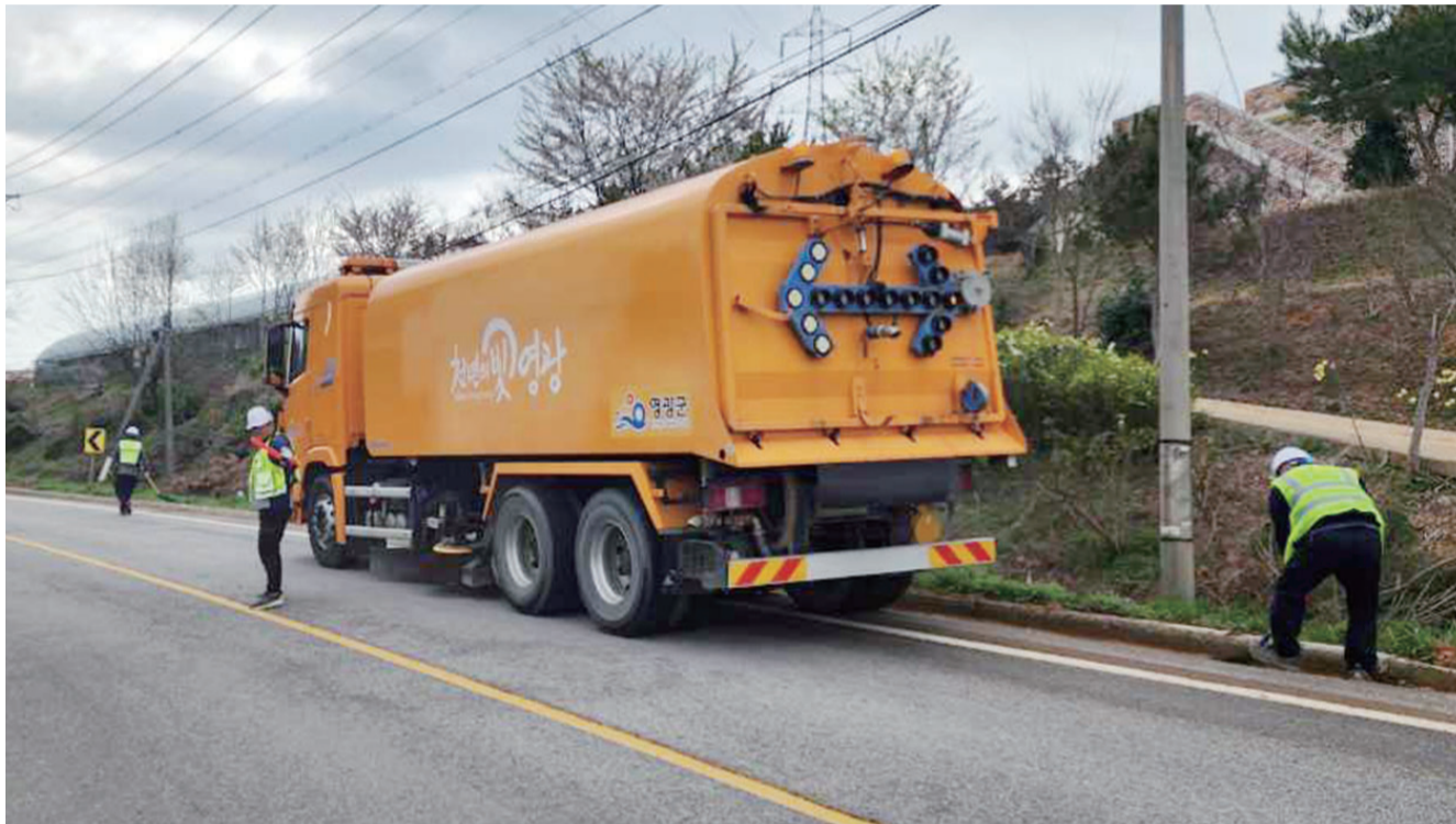
영광군이 겨울철 잦은 도로 제설작업과 강우로 인해 기능이 저하된 도로시설물 일제 정비를 펼친다.
